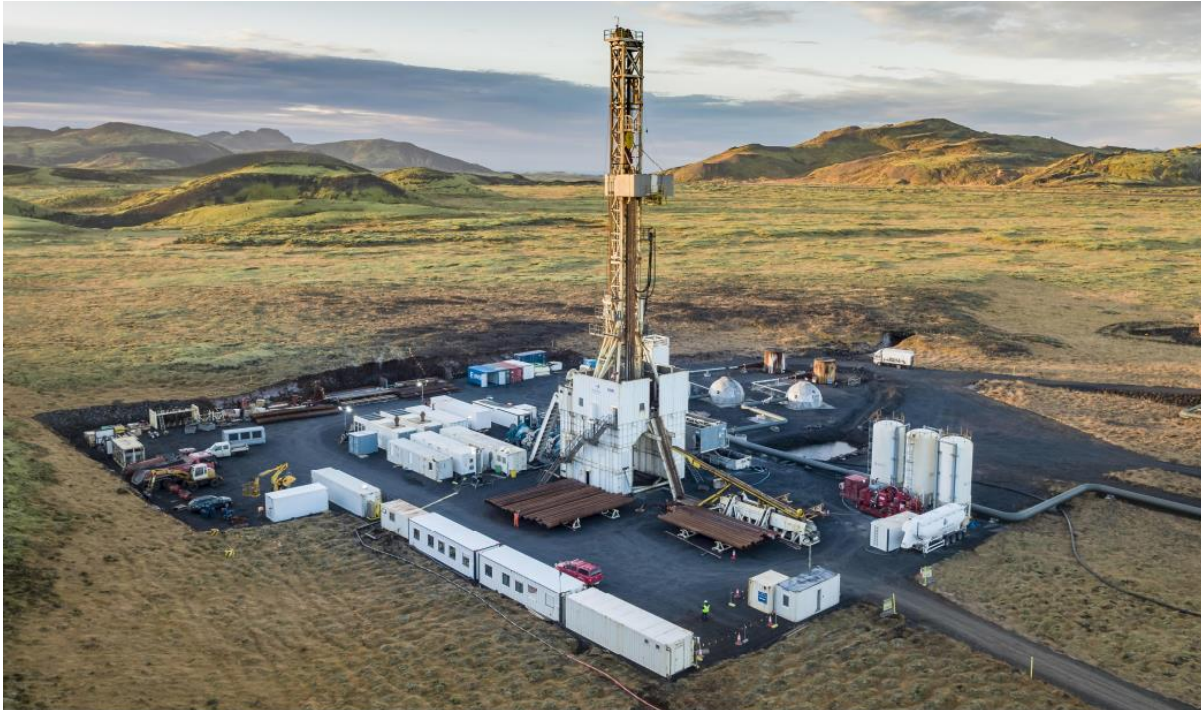
Mynd 4.3 Yfirlit yfir borplan þar sem verið er að bora viðbótarholu og fyrir eru 2 borholur á borplaninu. Borinn er fyrir miðri mynd. Hægra megin við borinn má sjá svarfþró á milli kúluhúsa og sílóa. Á milli svarfþróar og bors er dælukar. Sílóin geyma þurrefni í steypuna. Framan við borinn má sjá brún rör, sem eru borstangir notaðar við borunina. Mynd frá Jarðborunum hf. (Verkís, 2020).
